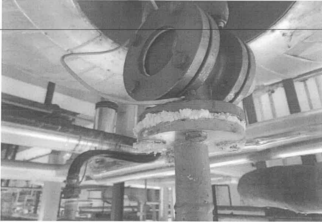
附件 25 整改前：多功能二层酯化釜（R2301）底部视镜法兰渗漏。
