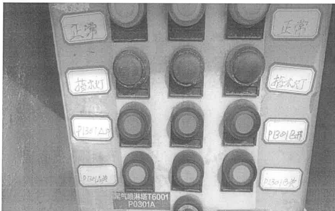
整改后：三废处理北固废库东侧尾气吸收塔操作柱按钮进行重新标识。
